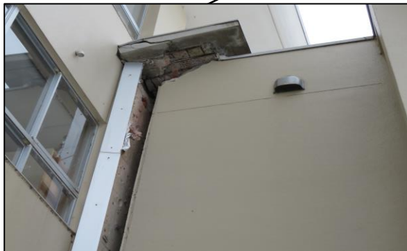
輪島高校（校舎継ぎ目破損）
