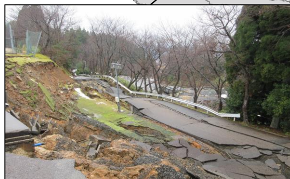
穴水高校（通学路崩落）
