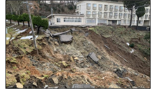
能登高校寮（敷地崩落）
