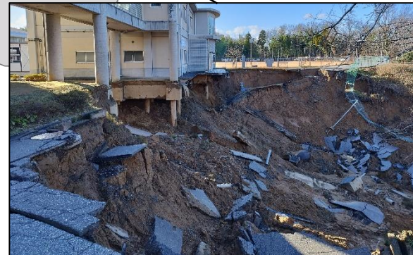
金沢北陵高校（法面崩落）
