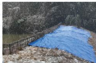
ため池堤防の崩壊（輪島市小伊勢町）
