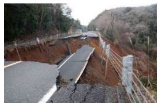
道路崩落（のと里山海道）
