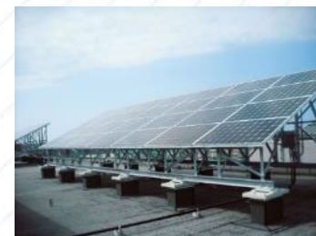
太陽光発電設備
