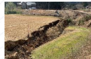
農地の地割れ（珠洲市若山町中）
