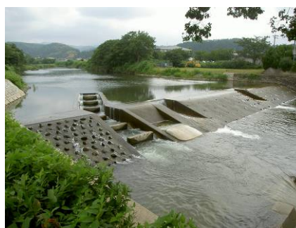
アユ等が遡上しやすいよう魚道勾配を緩く改良整備 (大聖寺川／加賀市)
