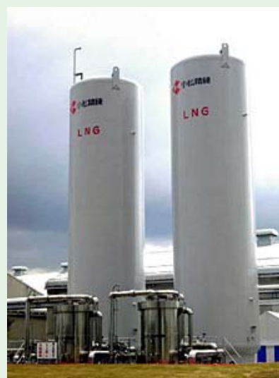
美川工場の LNG 施設
