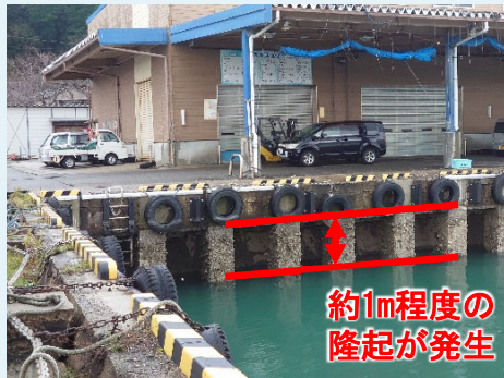
輪島港（輪島市）
