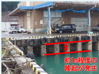
輪島港（輪島市）
