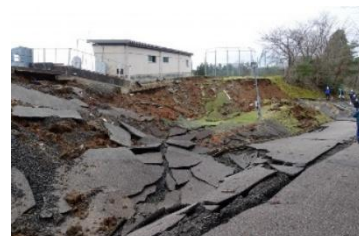
地震による被害
