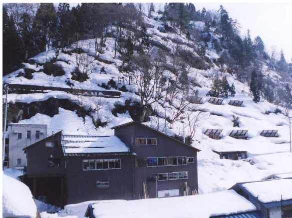
■ 雪崩防止柵の設置
