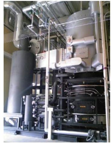
バイオマスボイラー
