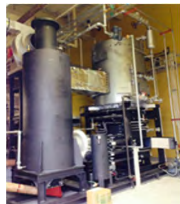
バイオマスボイラー
