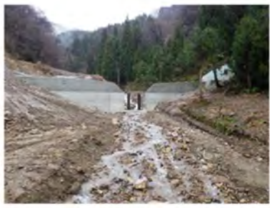
流木の流入防止 (白山市木滑地内)
