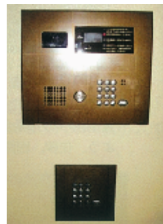
来訪者を写すカメラが付いたオートロック操作盤
