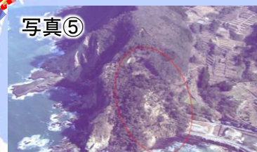
国道249号トンネル坑口崩落
