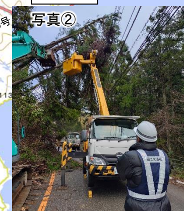
電線にかかる倒木が発生 (作業完了)
