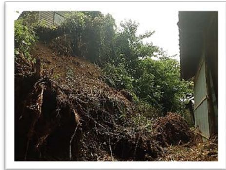
がけ崩れの被災事例
