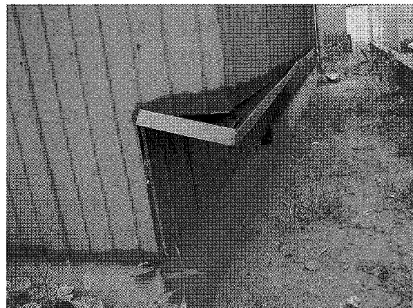
写真-2 サイディングの劣化状況
