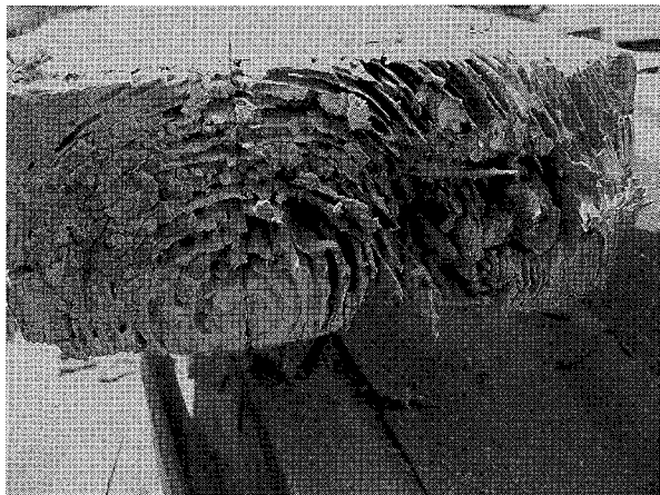
写真一七 梁蟻害部断面
