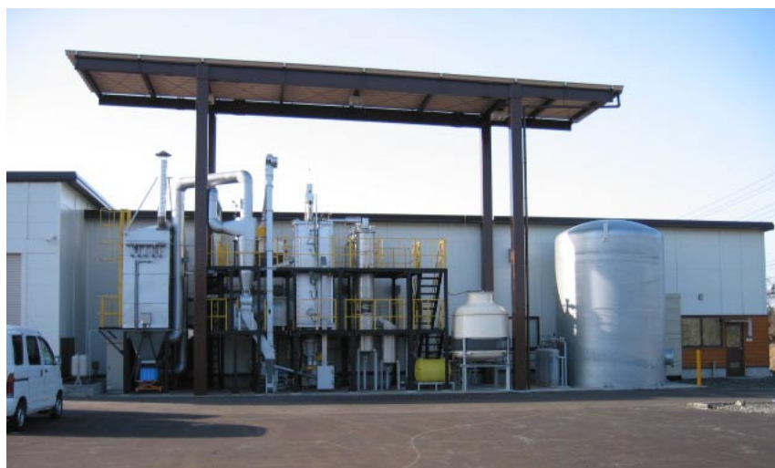
試験プラントの外観：中央の箱形の部分がガス化炉
