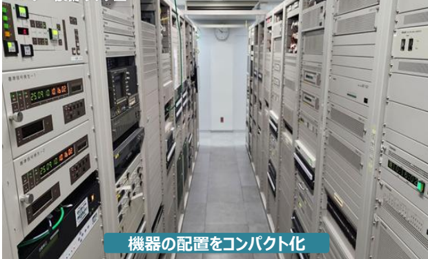
マスター設備ラック室
