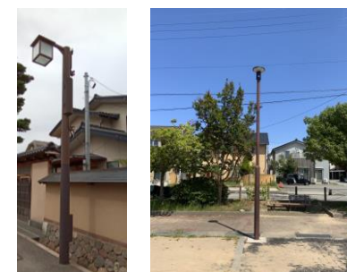
道路灯・公園灯
