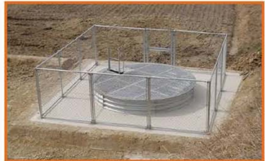
地すべり対策事業で整備された集水井
