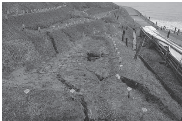
白米千枚田のひび割れ（輪島市）
