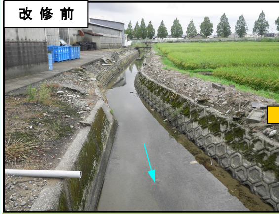
水路断面が小さく、老朽化していた
