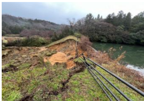
ため池の堤防崩壊(宝達志水町)
