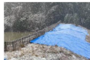
ため池堤防の崩壊 (輪島市)
