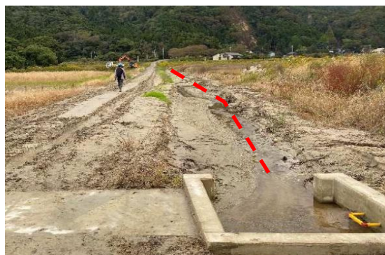
水路埋塞(輪島市)
