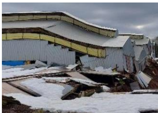
畜舎の倒壊(能登町)
