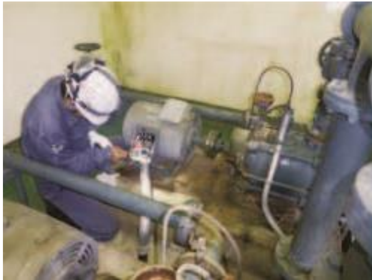
ポンプ点検状況
