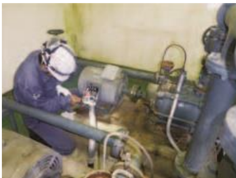
ポンプ点検状況
