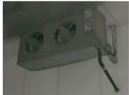
図3. 空調設備の管理
