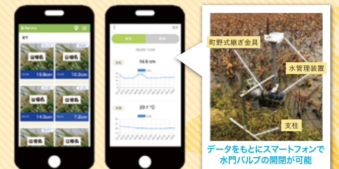
データをもとにスマートフォンで水門バルブの開閉が可能 町野式継ぎ金具 水管理装置 支柱 データをもとにスマートフォンで水門バルブの開閉が可能
