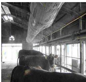
【送風ダクトホースと併用した細霧装置】
