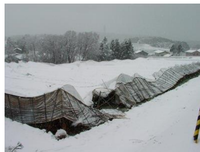
連棟ハウスは特に雪に弱い
