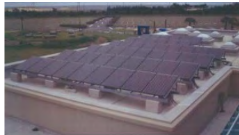
太陽光発電施設
