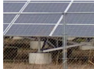
<太陽光発電施設>
