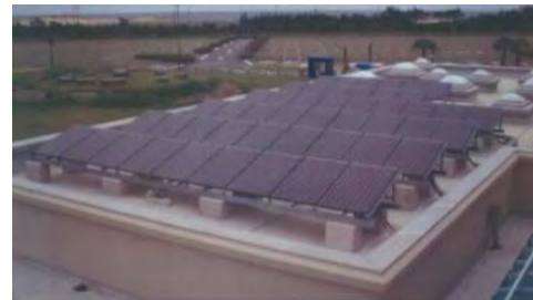
太陽光発電施設
