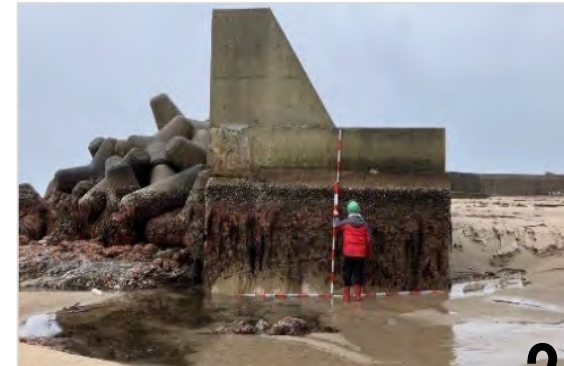
地盤隆起 (鹿磯漁港(輪島市))
