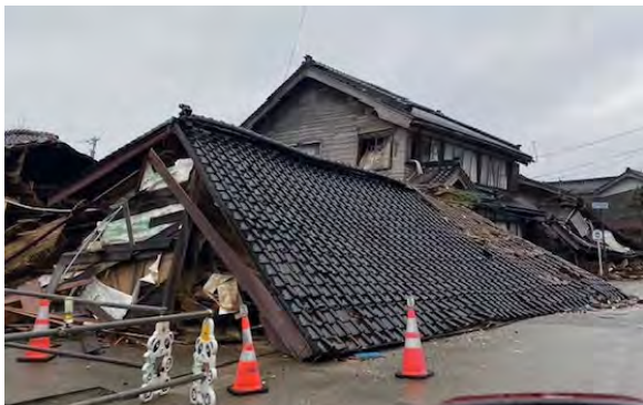
家屋倒壊 (珠洲市三崎町地内)
