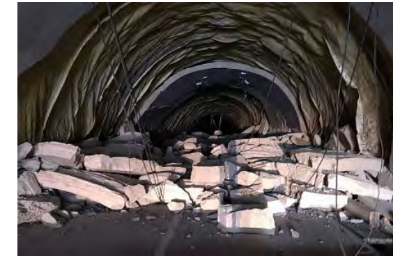
トンネル崩壊 (国道249号)
