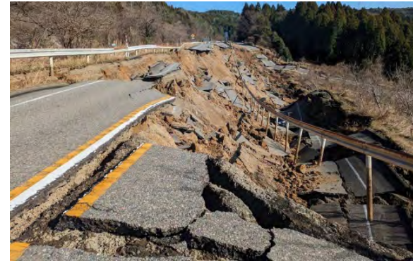
道路被害 (のと里山海道)
