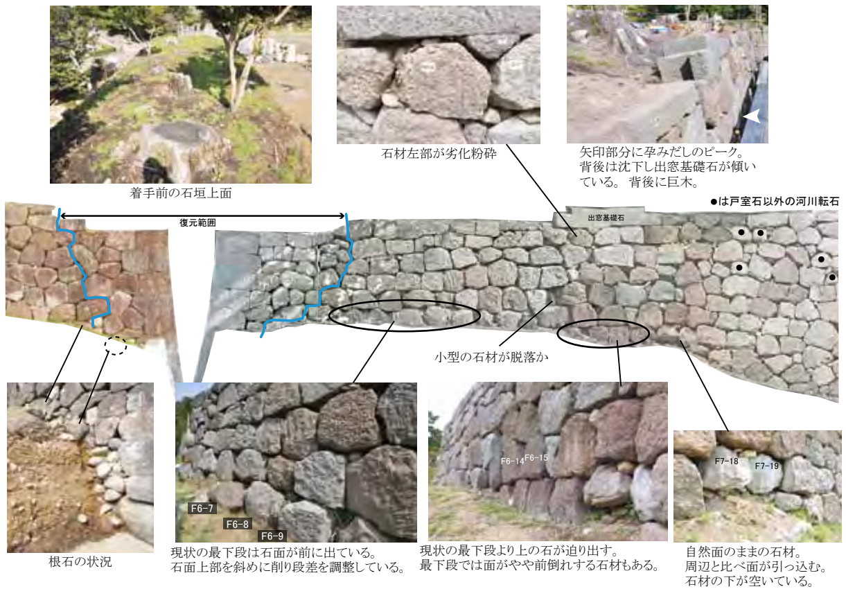
石垣の変形状況
