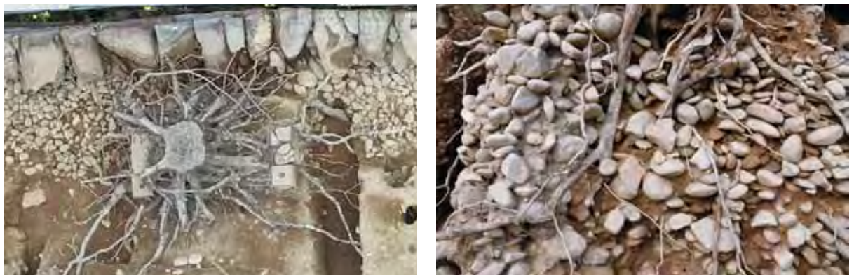
石垣背後の樹木根の状況
