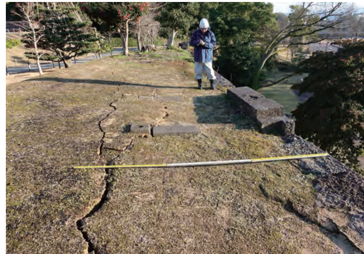
⑪ 玉泉院丸南西石垣・南石垣 変形（地割れ +77mm）
