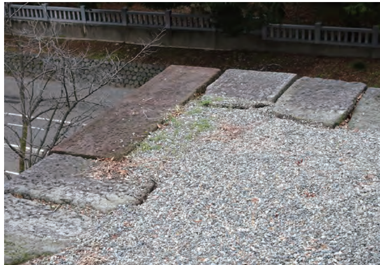
④ 玉泉院丸北鼠多門続櫓台石垣 変形（天端迫出し）
