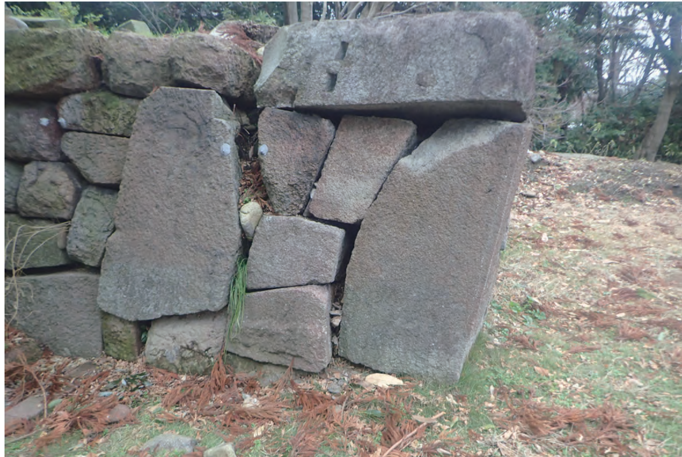
① 数寄屋屋敷北西櫓台石垣 変形 (前倒れ増大 +7mm)
