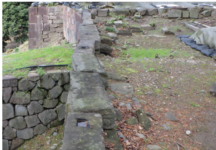
⑨ 玉泉院丸北東納戸土蔵下石垣 変形（天端迫出し）
