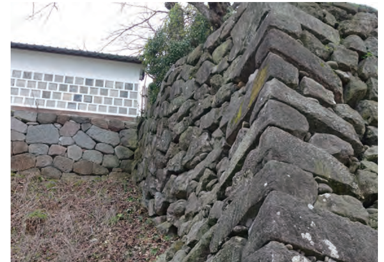
㉑ 三ノ丸北石垣東面 変形（孕み増大 +33mm）
