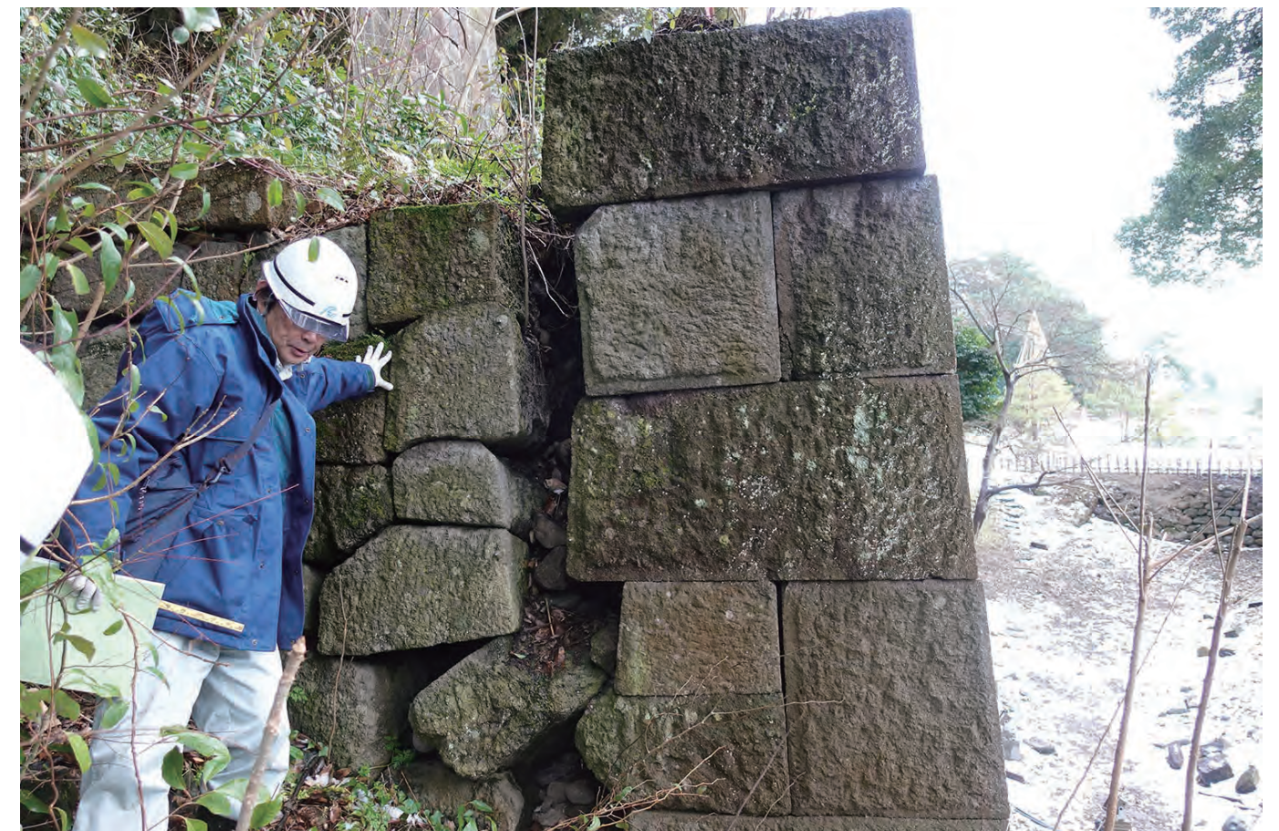
⑤ 玉泉院丸北数寄屋門下泉水縁石垣 変形 (前倒れ増大 +98mm)
