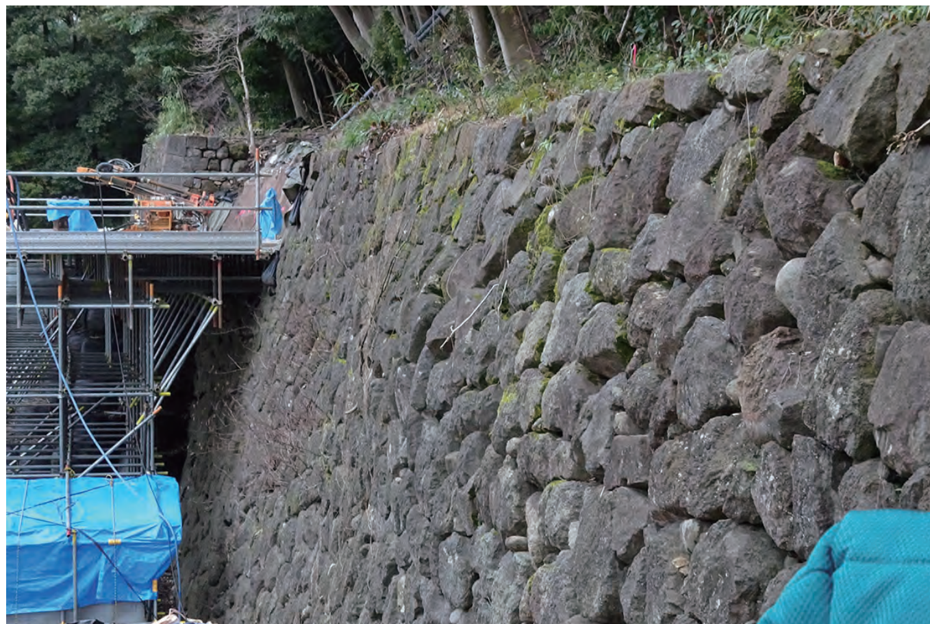
② 数寄屋屋敷西堀縁石垣 (丸の内園地) 変形 (孕み増大 +72mm)
