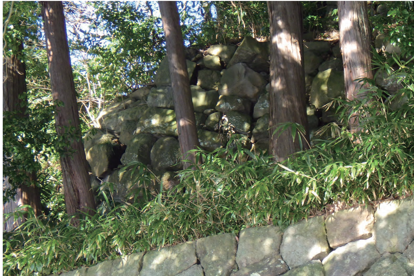
⑭ 稲荷屋敷石垣 変形 (孕み増大 +15.9mm)
