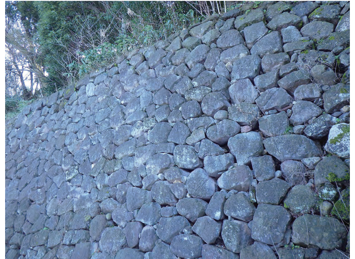
⑯ 数寄屋敷西堀縁 (旧中央ビル裏) 変形 (孕み増大 +59mm)
