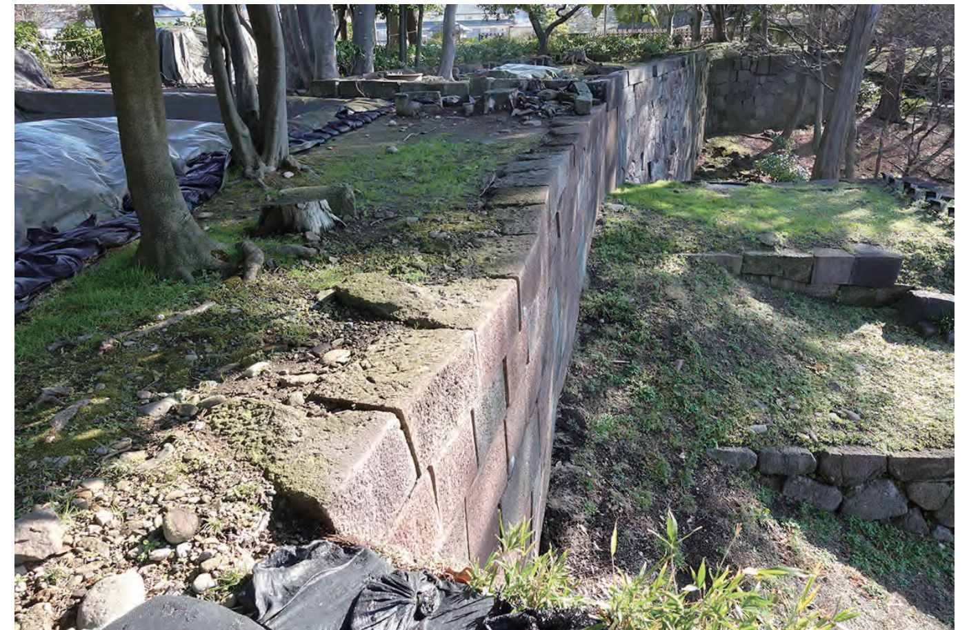
⑧ 玉泉院丸北東御居間先庭籠下石垣 変形 (前倒れ増大 +50mm)
