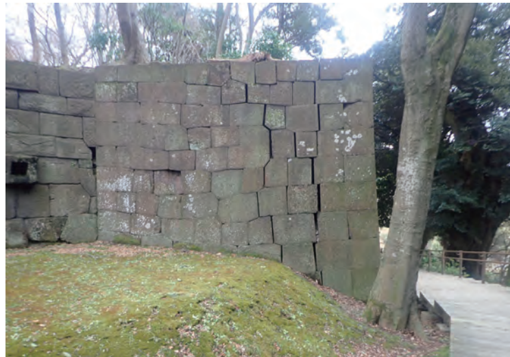
③ 玉泉院丸北御居間先土蔵下石垣 変形（前倒れ増大 +3mm）
