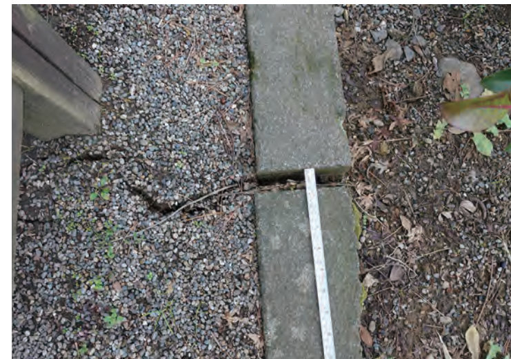
⑱ 東ノ丸南東石垣 変形（地割れ）
