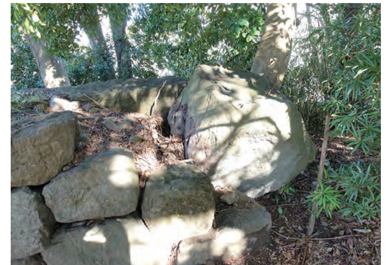
⑳ 尾坂門南石垣（東） 変形（落石）
