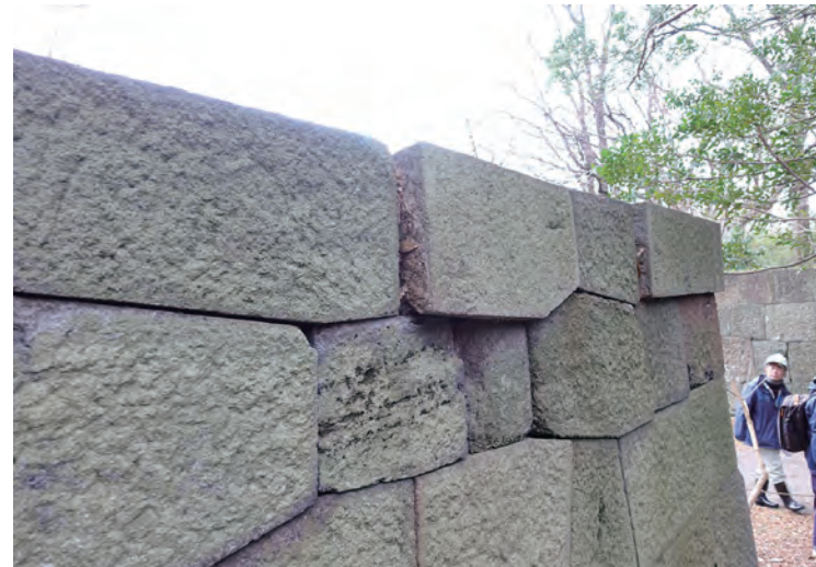
⑮ 本丸西鉄門南石垣 変形（天端迫出し増大）
