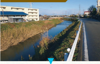
土砂除去前の金腐川(金沢市)
