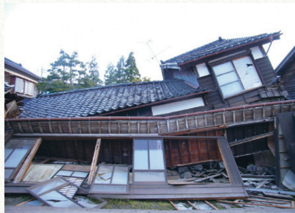
地震が起きた時には建物倒壊がとて危険
