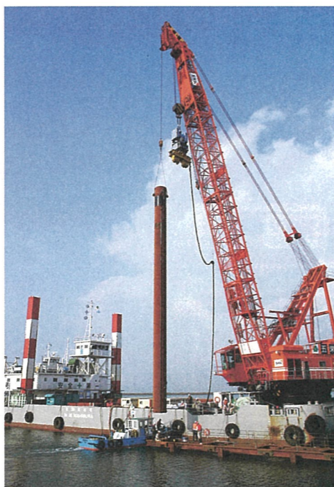
大水深岸壁の下部を支えるくい打ちが行われるなど、平成20年秋の暫定供用に向けて着々と整備が進んでいます
