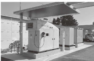
水素ステーション
