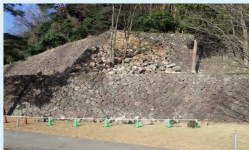
令和6年能登半島地震 で損傷した石垣
