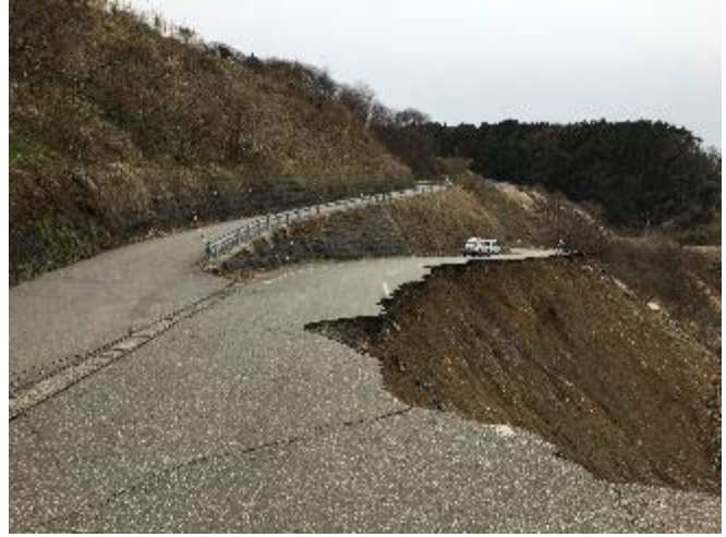
・被災状況（輪島市街方面から大沢町方面を望む）
