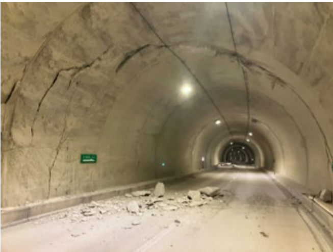
・被災状況（地震直後）
