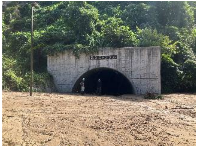
・豪雨後の被災状況（皆月側坑口）
