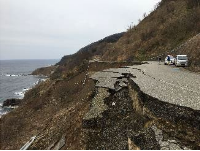
・被災状況（大沢町方面から輪島市街方面を望む）
