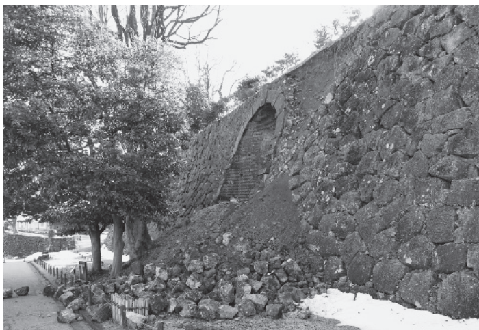
金沢城跡 本丸北石垣 崩落状況
