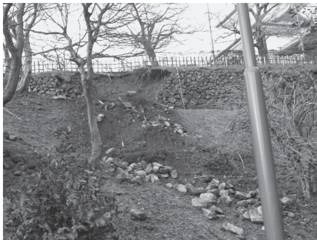
金沢城跡 石川門前土橋石垣 崩落状況
