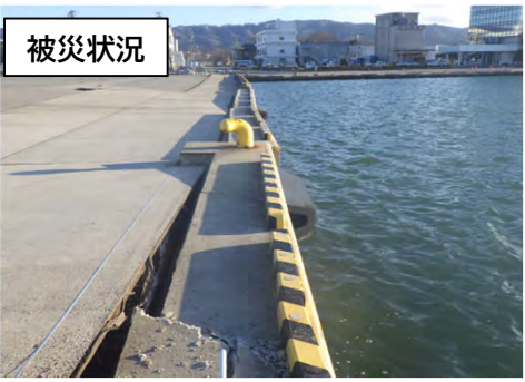
法線のはらみ出し
