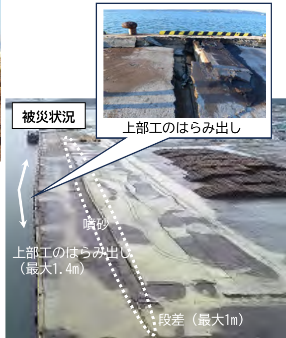
岸壁法線のずれと噴砂(物専岸壁)
