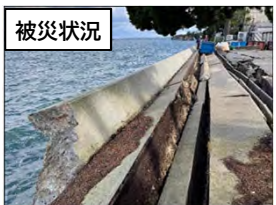
護岸崩壊及び傾斜
