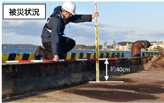
液状化によるエプロンの沈下(物専岸壁)
