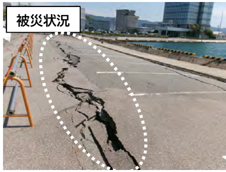
背後のひび割れ (第一西岸壁(-5.5m))
