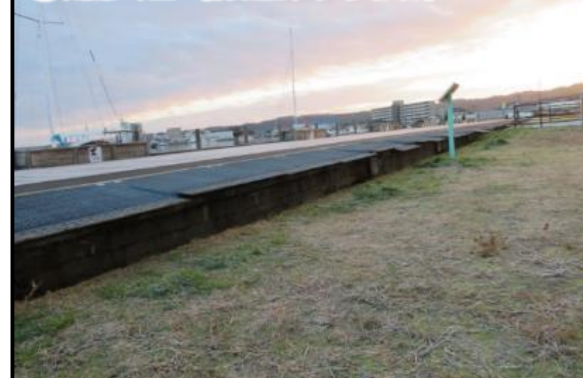
②遊歩道（段差、クラック）
