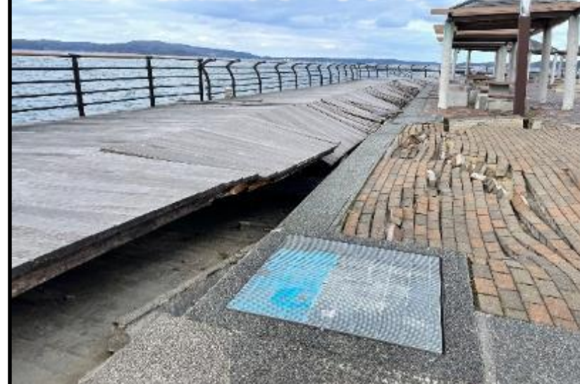
①護岸（段差、ボードウォーク損傷）
