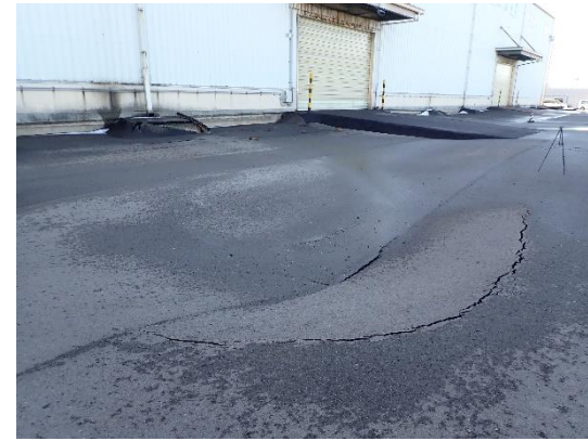
ふ頭用地陥没
