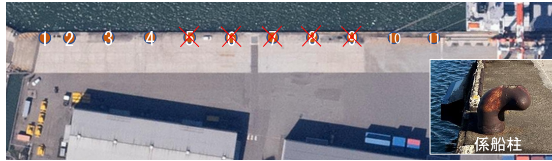
11基の係船柱のうち5基が使用不可
