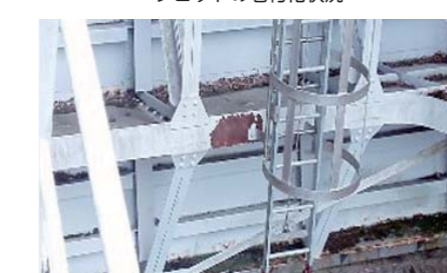
ダムゲートの老朽化状況
