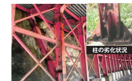
シェッドの老朽化状況
