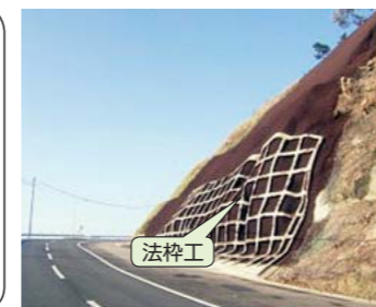
法面落石対策
