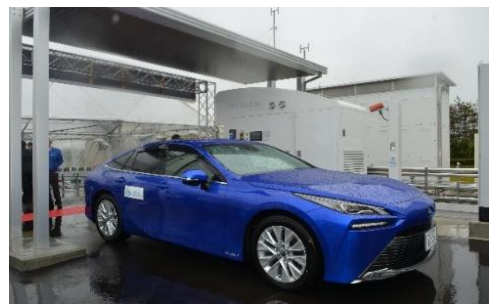
R5.4に開所した水素ステーション （のと里山空港敷地内）
