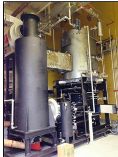
木質バイオマスボイラー
