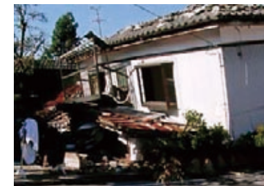
地震により倒壊した家屋(新潟県長岡市)
