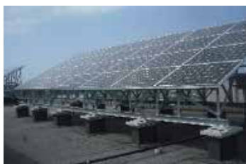
公共施設の屋上に設置した 太陽光発電施設
