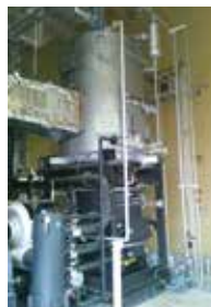
バイオマスボイラー
