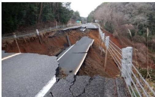
<道路崩落(のと里山海道)>
