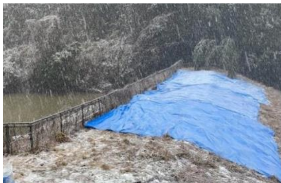
<ため池堤防の崩壊(輪島市小伊勢町)>
