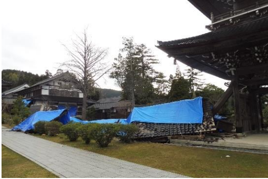
< 總持寺祖院(輪島市)の被害 >
