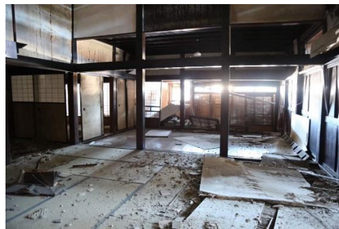
< 中谷家住宅(能登町)主屋内部の被害 >
