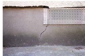
基礎のひび割れ
