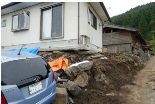
写真10 崩壊した擁壁
