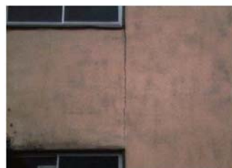
外壁の ひび割れ
