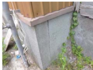
基礎の ひび割れ
