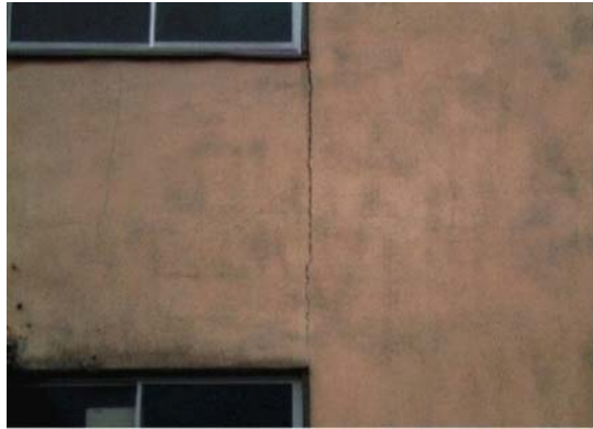
写真Ⅱ.2.3.2 モルタル外壁に生じた大きなひび割れ
