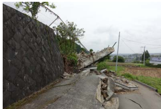
写真11 崩壊した擁壁
