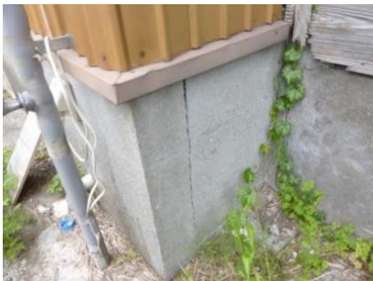
写真Ⅱ.2.3.3 基礎の割れ
