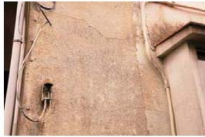
外壁のひび割れ・こけ
