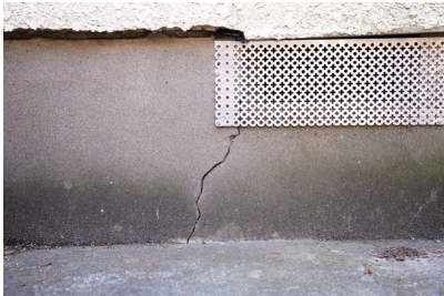
換気口付近のひび割れ
