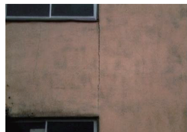
外壁のひび割れ
