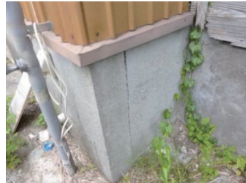
基礎のひび割れ
