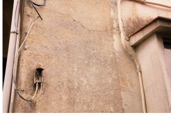
外壁のひび割れ・こげ
