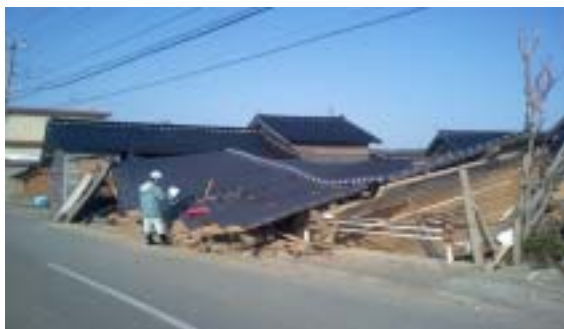
図 4-1 住宅の被害（輪島市門前町道下）
